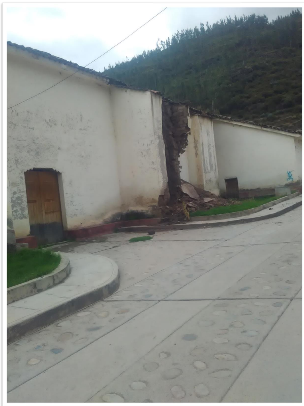
Derrumbe de la Parte posterior del templo
